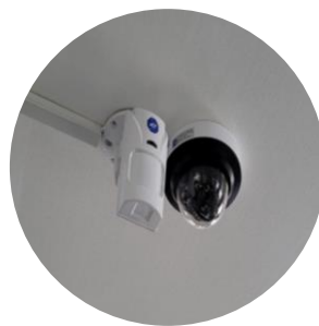
인쇄소 내 CCTV
